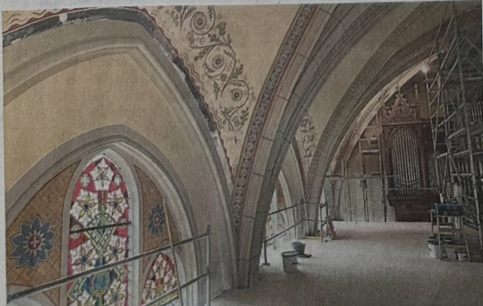
Die Ornamentbögen über den Fenstern an der Südwand sind beinahe komplett wieder retuschiert, auch die restliche Wand ist bereits von der Dispersionsfarbe befreit.
