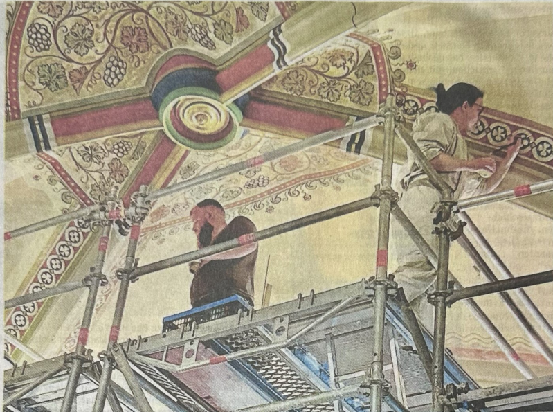
Für die Freilegung der Quensen-Malereien in den Gewölben der Lutherkirche sind aktuell nur noch letzte Restarbeiten notwendig. Parallel dazu hat die Sanierung der Südwand bereits begonnen. Fotos: Nachtwey
